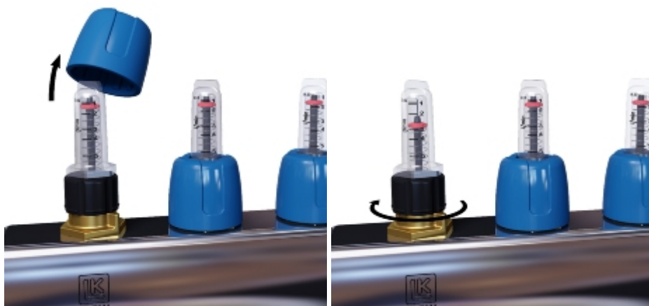
Injustering av kretsflöden. Injustering utförs med "handkraft", verktyg t.ex. polygrip får inte användas.
